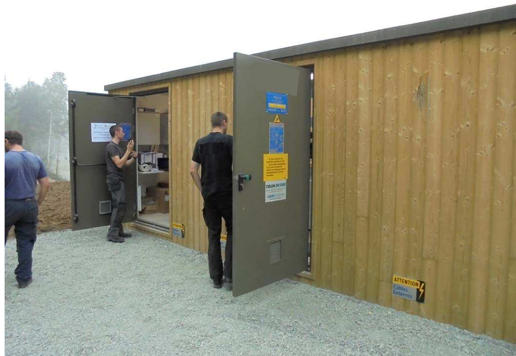
Photo 15 : Exemple de poste de livraison
